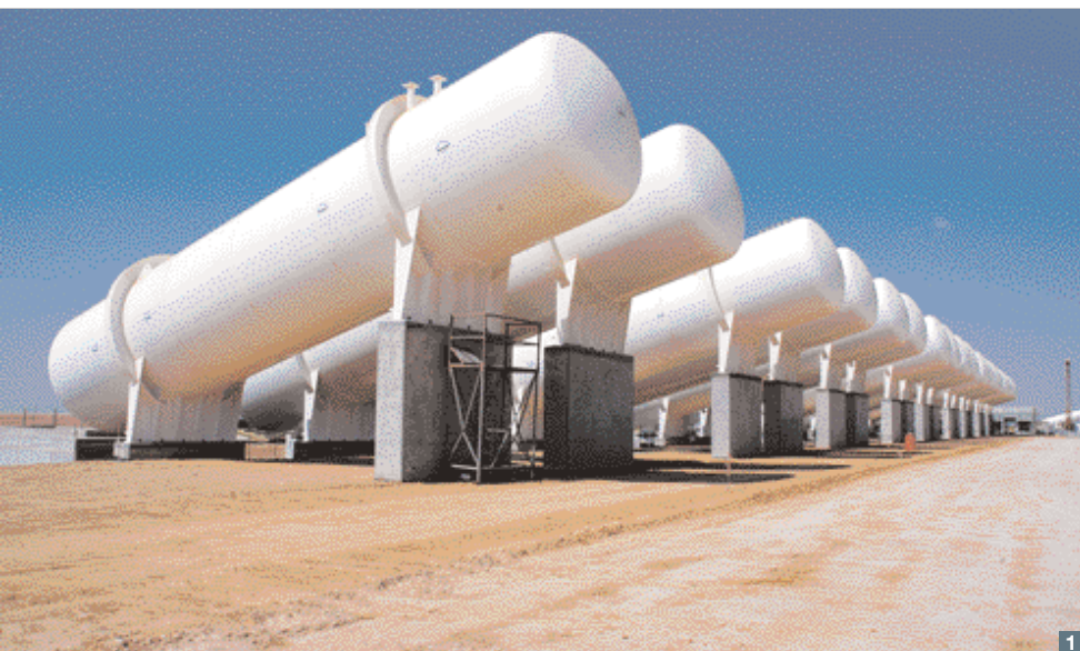
1. Le site d'Assdada, situé à 200 km à l'ouest de Sirte, est équipé de réservoirs anti-bélier haute pression.
